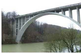
...Risse im Beton...
